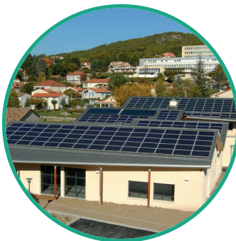
Les installations en toiture
