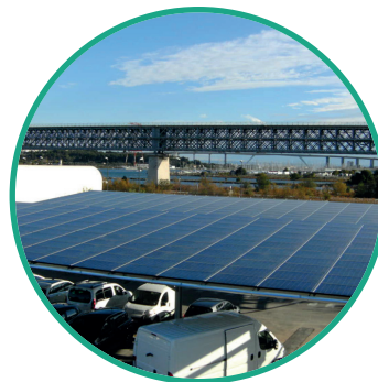
Les ombrières de parking
